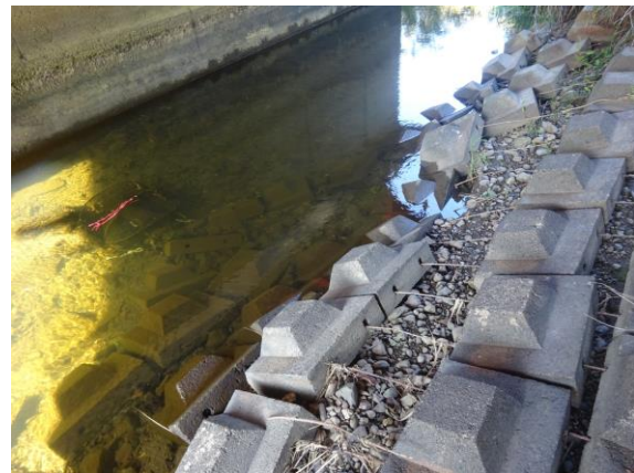
図3 ウチダザリガニが潜む損傷した護岸
